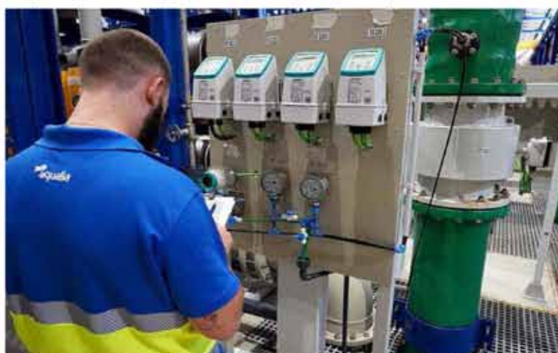
La tecnología permite predecir y evitar las pérdidas de agua, lo que redonda en un importante ahorro del recurso.
