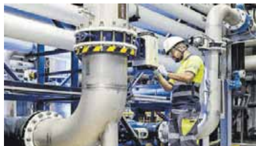
La planta potabilizadora del Besòs triplicará su capacidad de producción de agua potable.
