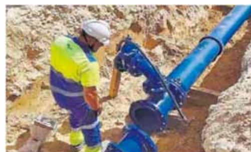
Un equipo realiza trabajos en la rotura de una tubería.
