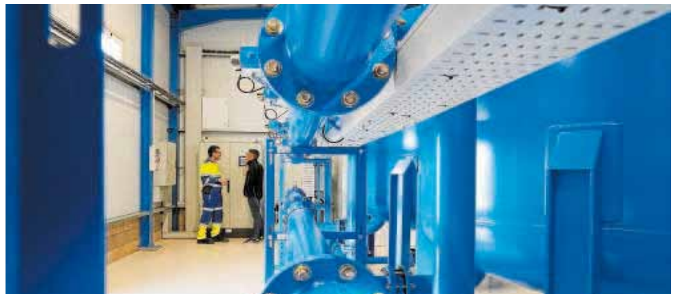
La mayor exigencia técnica y legislativa en la gestión del agua precisa de instalaciones con las últimas tecnologías
